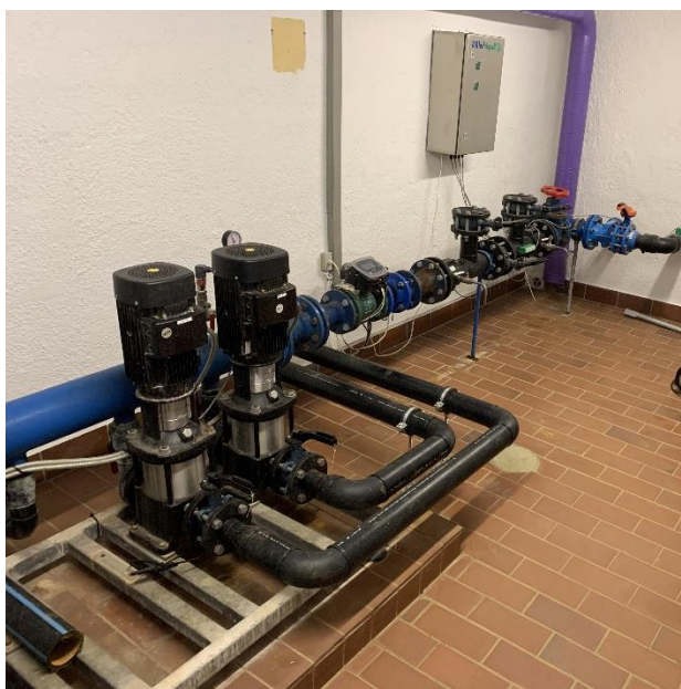
Rentvandspumper, vandmåler og prøvetagningshane, afgang vandværk
