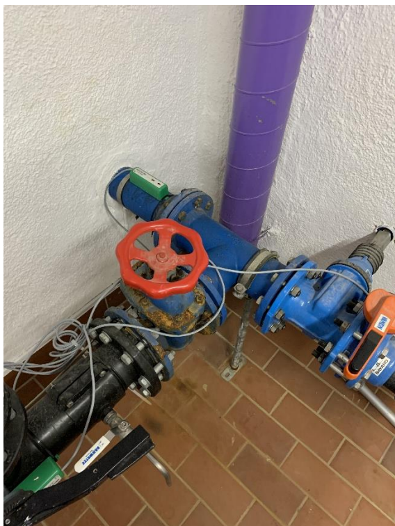
Ventil og prøvetagningshane efter blødgøring
